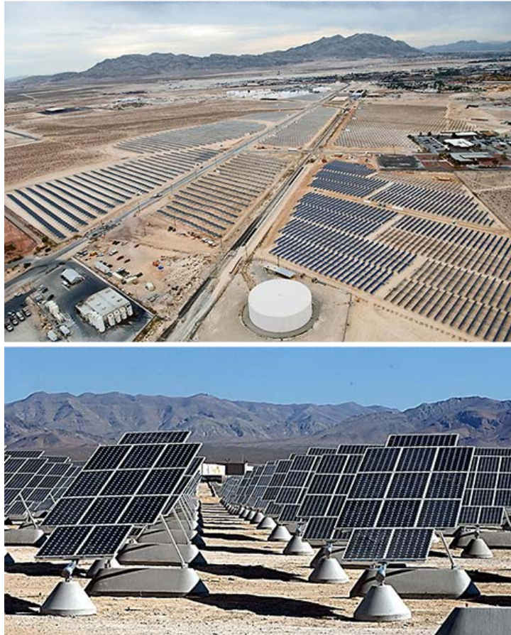
Fig. 17 - Nellis Air Force Base 140-acre solar farm
